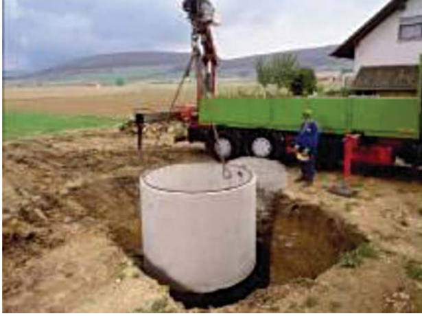
Şekil 18: Hazır betondan imal edilmiş monolitik toplama deposu / Mall 2011 /
